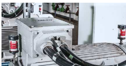
Lubricación de motor eléctrico
