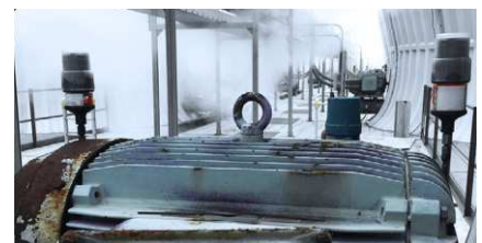
Lubricación de motor eléctrico
