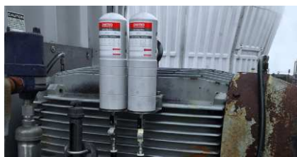
Lubricación de motor eléctrico
